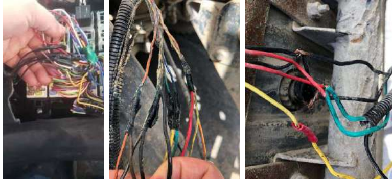
Uygun Olmayan Kablo Bağlantı Örnekleri
