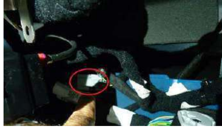
Tavan Üstyapı Elektrik Konnektörü
