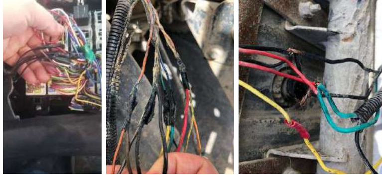
Uygun Olmayan Kablo Bağlantı Örnekleri
